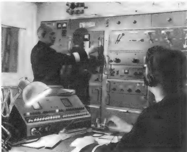
Bild 3. Wie eine Station auf dem Festland, so mutet einen der Blick in den Funkraum des Passagier-Turbinenschiffes Bremen (32 336 BRT) vom Norddeutschen Lloyd an (Einrichtung: Debeg; Funkstellenleiter: Erster Funkoffizier W. Finger)
